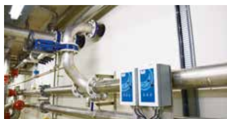
Après la fermentation, les boues sont transportées dans un stockage tampon avant la déshydratation finale.
