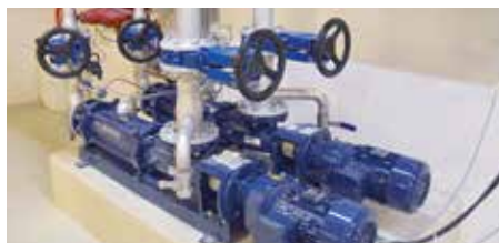
Les boues de la zone de clarification dans le réservoir DEMON® sont pompées et les bactéries anammox sont tamisées
