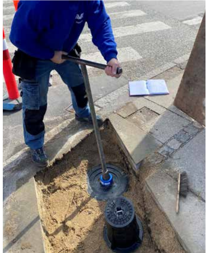
Vanne enterrée avec capteur de position VID I qui détecte sa manœuvre.
