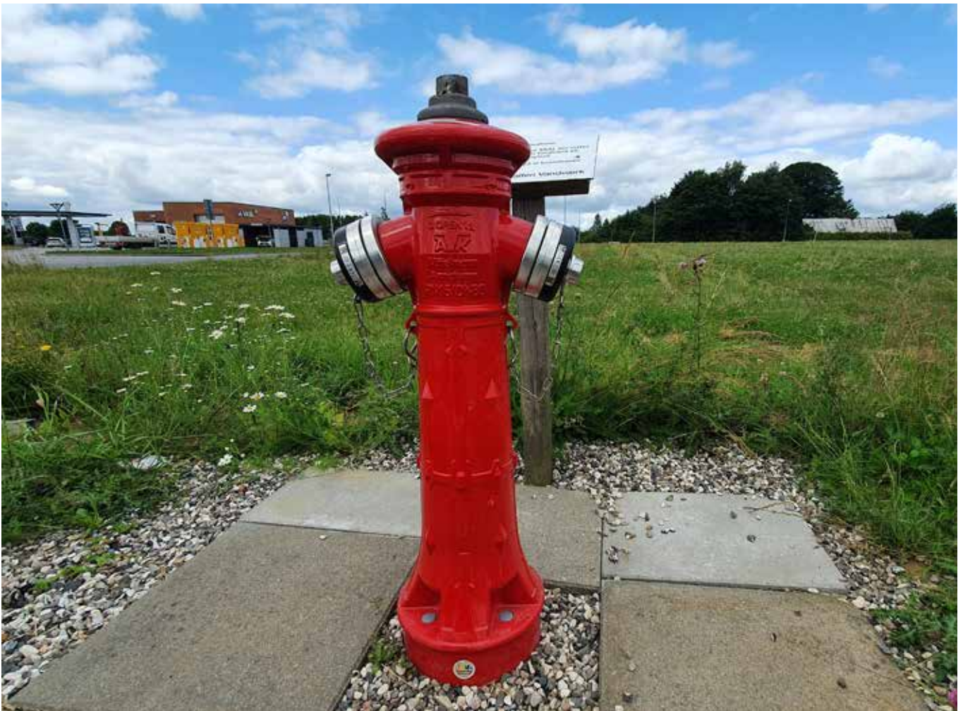
Poteau incendie avec bouchon VIDI Caps. L'utilisation d'un poteau incendie affecte la pression de la zone où il se trouve. Grâce au bouchon installé, il devient plus facile de faire la distinction entre une fuite et l'utilisation d'un poteau.
